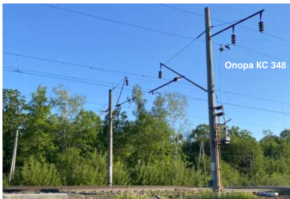
Рис. 5. Опора контактной сети 348
