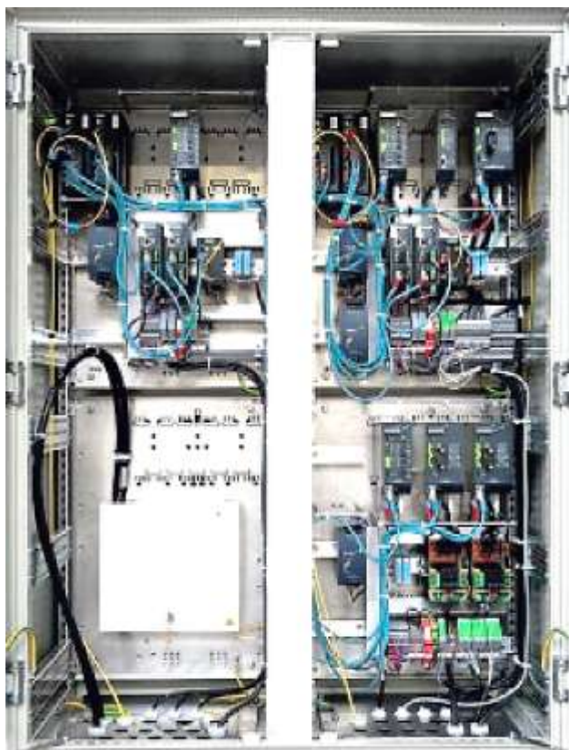
Рис. 3. Путевой шкаф Feak
